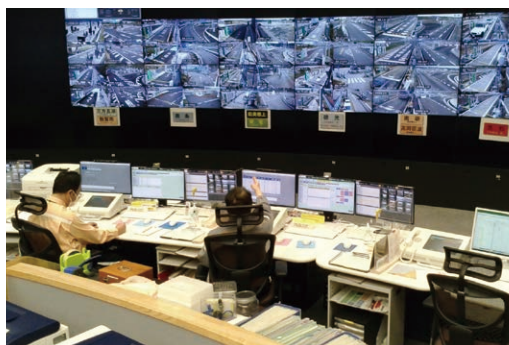
金沢スマートインター遠隔対応室
