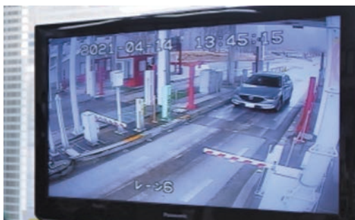
レーン監視画面
