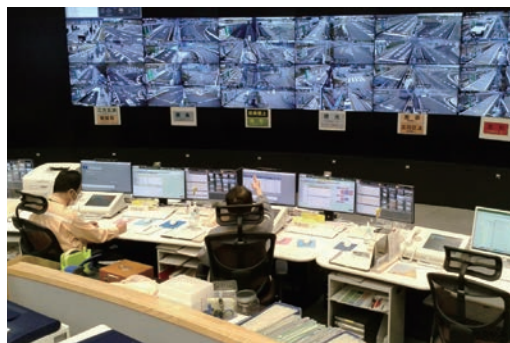
金沢スマートインター遠隔対応室
