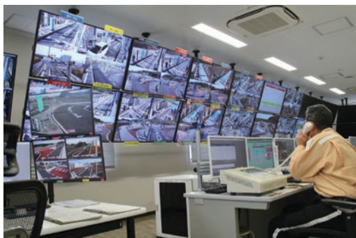
名古屋スマートインター遠隔対応室
